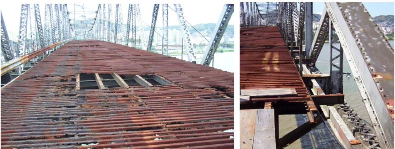
Figura 3 – Elevado estágio de corrosão do tabuleiro metálico.
